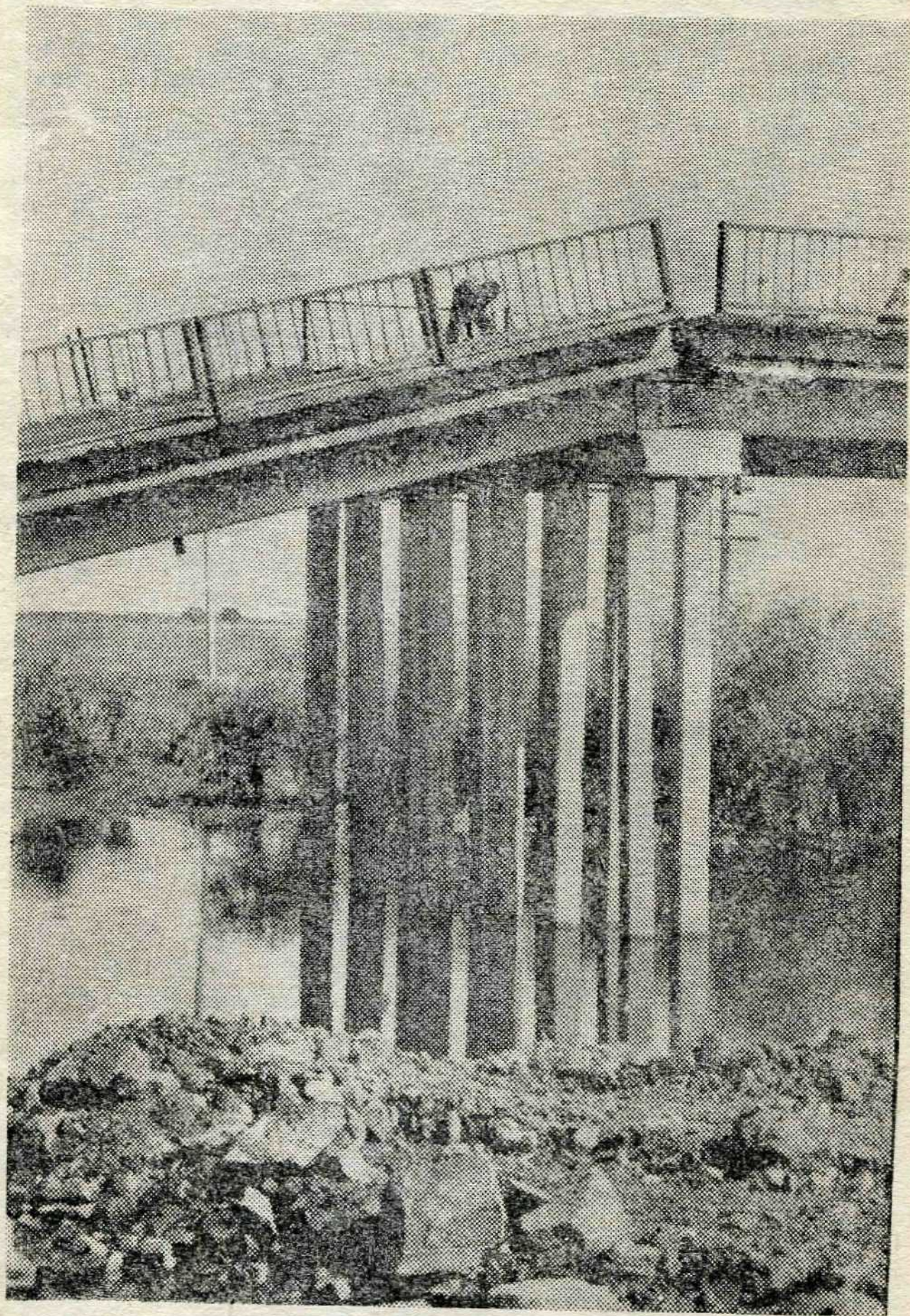
Мост, разрушенный во время наводнения, в Ленинском районе.
